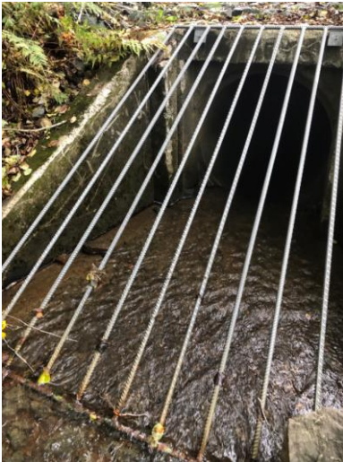
Figur 7-10 Styggedalsbekken som forsvinner i rør under Herre skole
